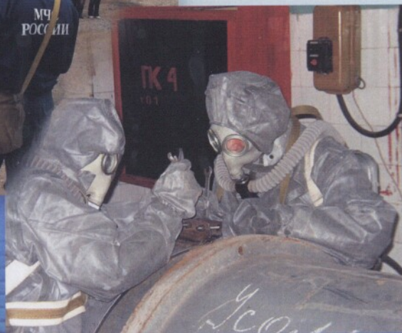
Ликвидация утечки хлора на водозаборе
